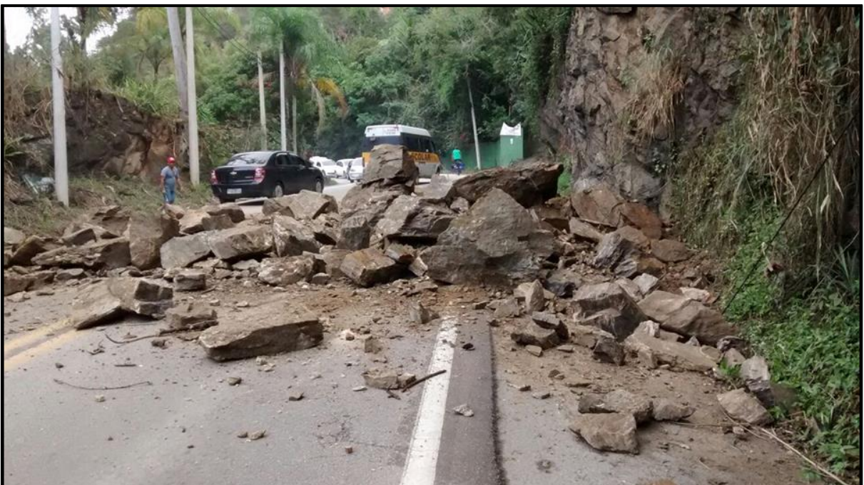
Figura 5 – Rompimento de talude no km 117 – setembro de 2015 (Folha do Litoral Norte, 2015 b).
