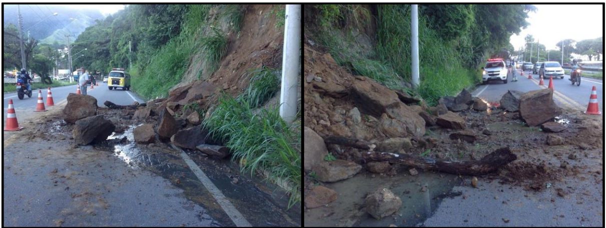
Figura 3 – Talude rompido no km 119 - março de 2015. (Portal G1, 2015; Folha do Litoral Norte, 2015a).
